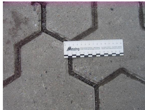
Flankenabriss erkennbar, Steine bewegen sich
