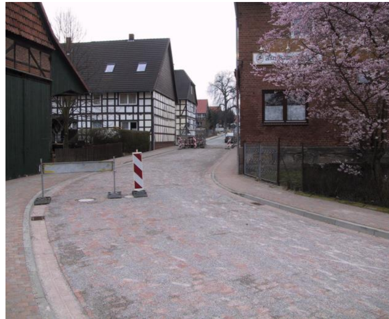
Fugensand auf der Fläche nach der Herstellung, um ein „natürliches“ Nachschlämmen bzw. Verfestigen der Fuge zu ermöglichen
